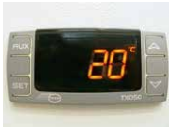
Armadio elettrico climatizzato
